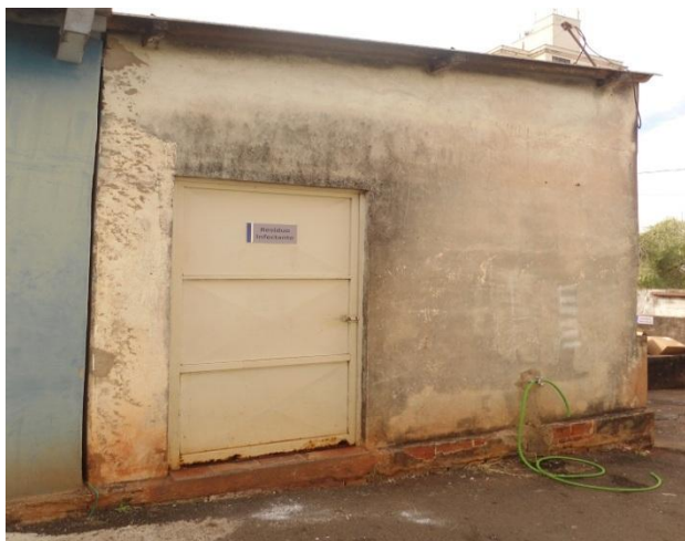
Figura 13 – Local de armazenamento temporário de RSS.
