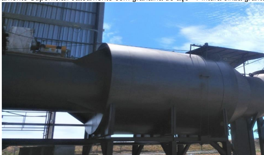
Câmara de Combustão Energia Limpa do Brasil - Vista Lateral
